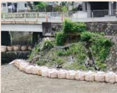
●崩れた川端通り下の護岸
