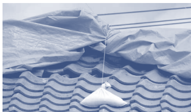
大阪北部地震で屋根の被害（伏見区淀地域）
