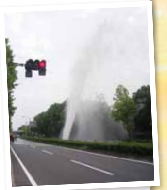
▲9月26日 北福西の漏水現場
