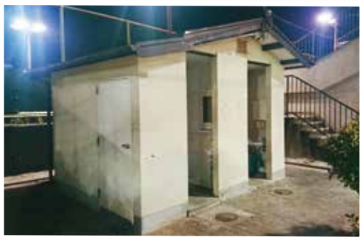
老朽化した西院テニスコートのトイレ
