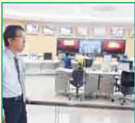
北部クリーンセンター内の中央制御室
